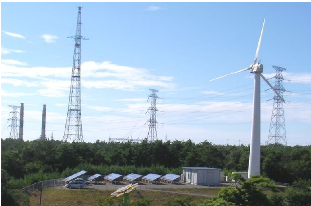
[北陸電力様 志賀風力・太陽光発電センター(石川県羽咋郡志賀町赤住)]
